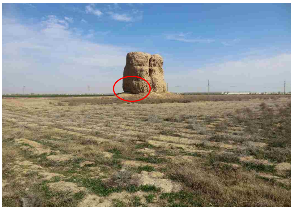
Фото 1 Разрушение нижней части ступы и направление её наклона
